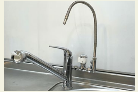
③分岐付き蛇口に交換し、分岐止水栓、リターンバルブを取り付ける。
